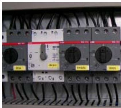
protectiv motor switches
